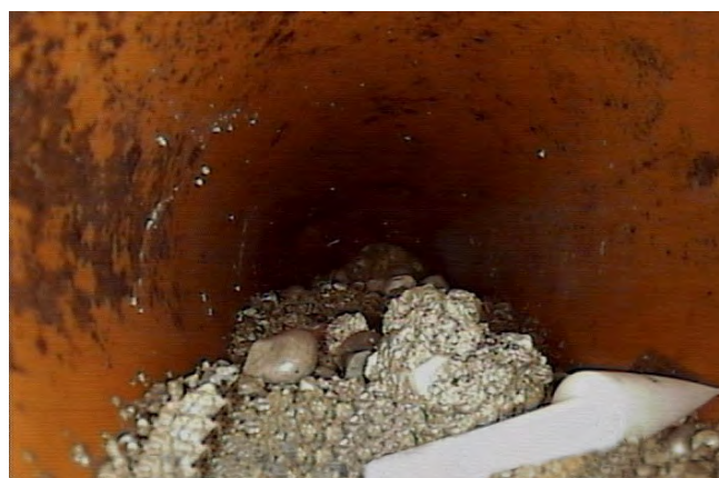
Abwasserkanal mit Ablagerungen von Abfall- und Unratresten, die zu ungewollten Verstopfungen führen
