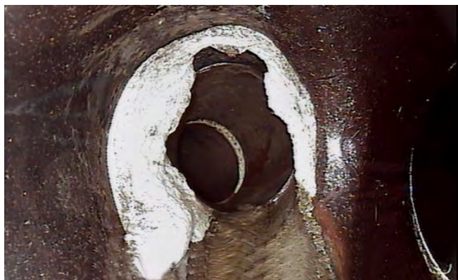
Fettablagerungen in den Abwasserkanälen. Deutlich sichtbar die dicke weiße Fettschicht
