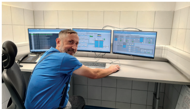
Wassermeister Andreas Huber am Leitsystem für alle Anlagen der Trinkwasserversorgung
